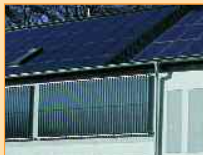
Impianto a facciata TUBO combinato con fotovoltaico, Lussemburgo
